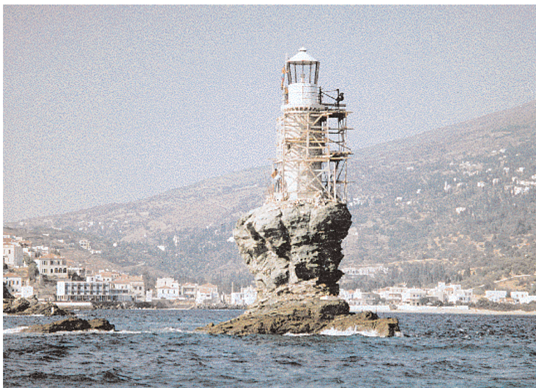
Εικόνα 46 . Ο Τουρλίτης, μπροστά στη Χώρα της Άνδρου, σχεδόν ολοκληρωμένος. Ο βράχος που σηκώνει το βάρος του χρειάστηκε και αυτός να ενισχυθεί, μια και παρουσίαζε αρκετές ρωγμές.
