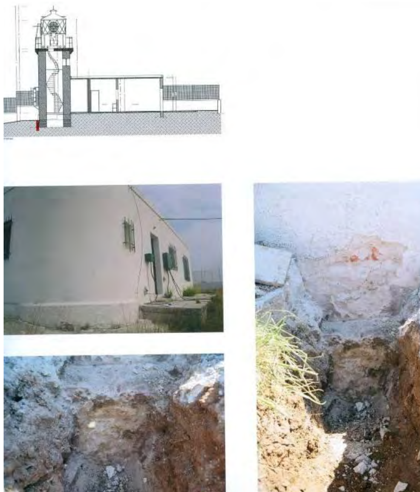
Εικόνα 70. Θεμελίωση πύργου φάρου Μεγάλου Εμβόλου, Αγγελοχώρι, Ελλάδα (υλικό της έκθεσης «Πέτρινοι φάροι: Από το χθες στο σήμερα» (13-26/10/2007), 42α Δημήτρια, Θεσσαλονίκη. Διοργάνωση: Εργαστήριο Δομικών Υλικών, Τμ. Πολιτικών Μηχανικών, ΑΠΘ. Συνεργαζόμενος φορέας προγράμματος: Υπηρεσία Φάρων-Π.Ν.α)
